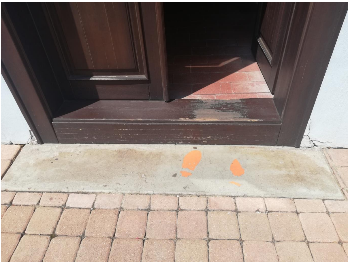
• Detail vstupných dverí, prahu, v sokli. V sokli vidieť drobné trhlinky.
