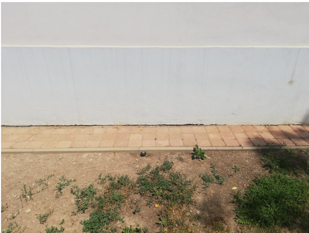
• Časť sokla západnej fasády Rodošta. Na povrchu sú drobné trhliny a stečence po zrážkovej vode.
