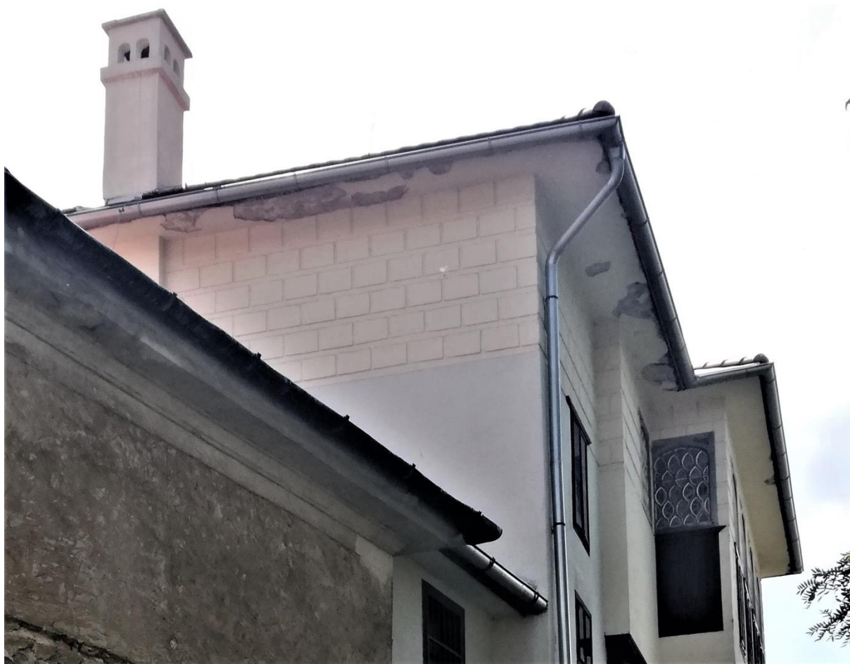
• Detail východnej fasády Rodošta, kde sú väčšie úbytky omietkových vrstiev podhľadu strechy.
